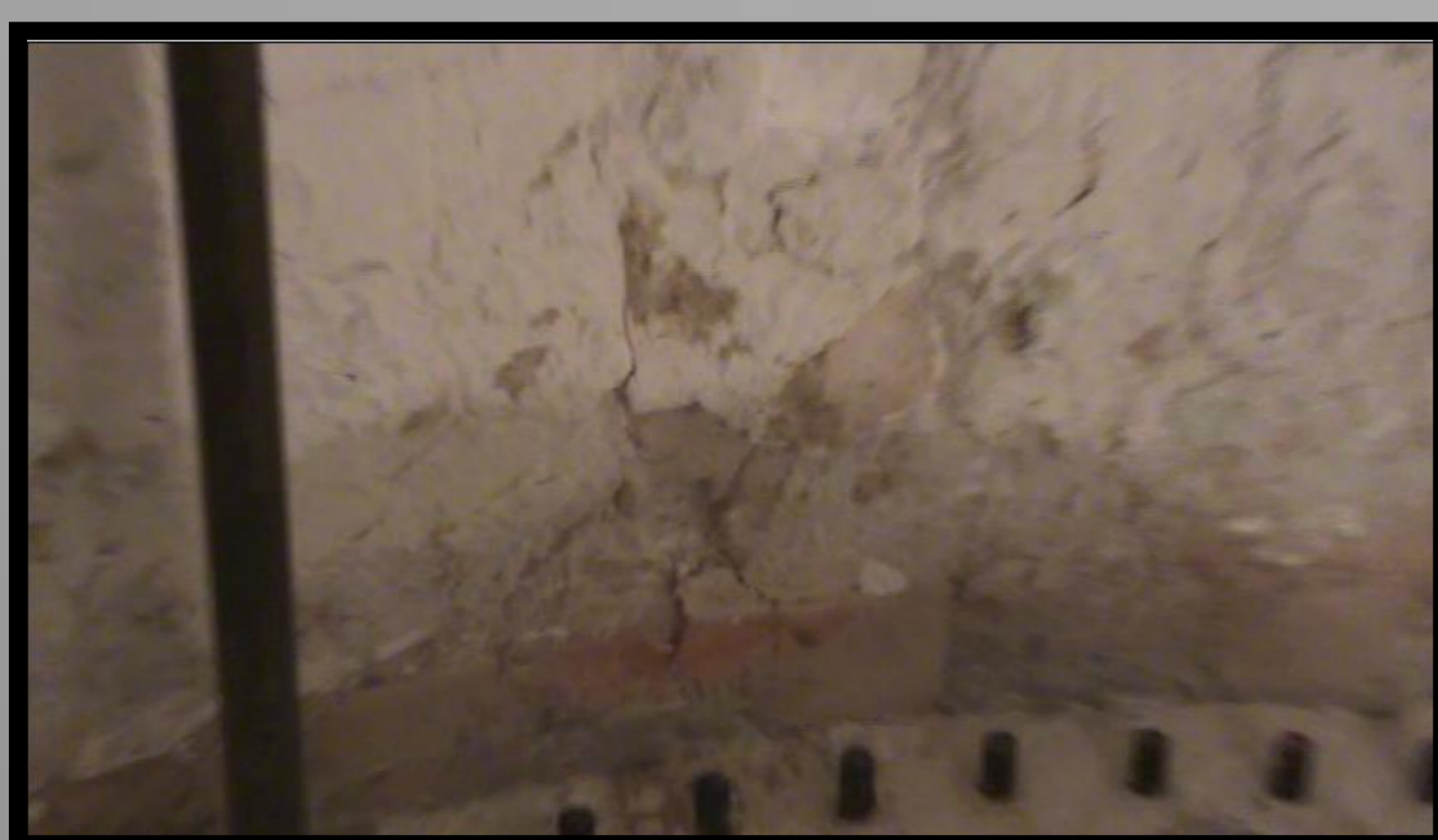
Fig # 5 – área de refratário danificado
