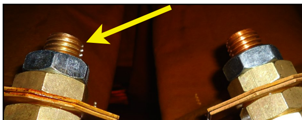
Imagen 6. Imagen visual del tornillo interno del bushing que hace la conexión a los terminales del transformador.
