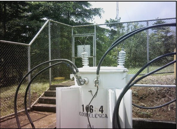
Imagen 1. Imagen visual del transformador inspeccionado
