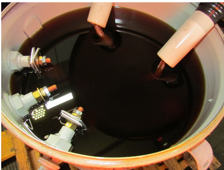
Coloración anormal del aceite del transformador.
