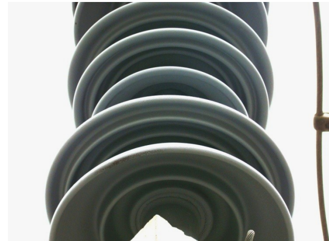
3 – Isoladores com RTV
